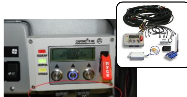
Автоматическая система контроля пожарной безопасности
