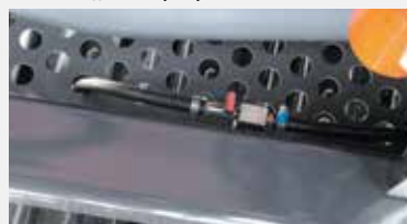
Кран для слива отстоя из топливного бака
