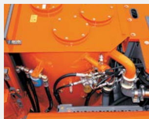
Фильтры на стенке центрального прохода
